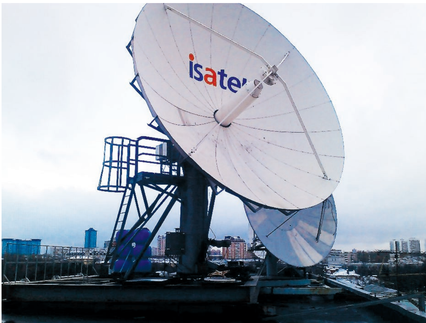
Центральная станция космической связи ООО «Исател» в Москве Isatel hub station at Moscow
