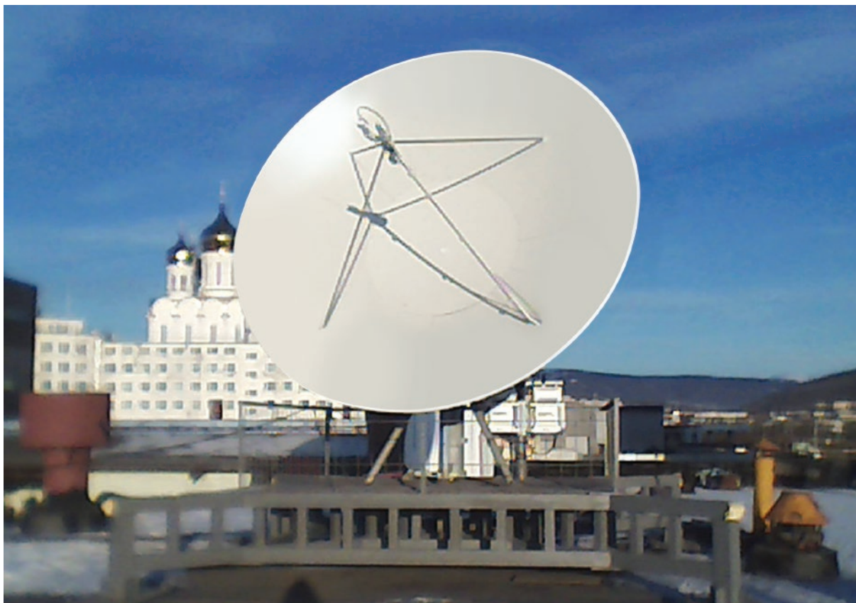
Станция, установленная в г. Магадане Earth station installed in Magadan
